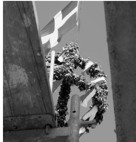
Ophængt i en storkran hang kransen, og Dannebrog vajer over byggepladsen. (Foto: SPT)
